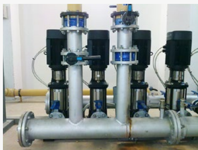
Colector a reformar por oxidación interior.
